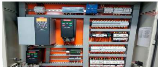
Sistema Eléctrico en buen estado
